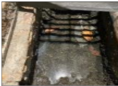
지하차도 배수로 이물질 퇴적
