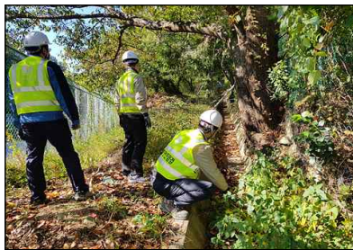
사면 배수로 이물질 퇴적
